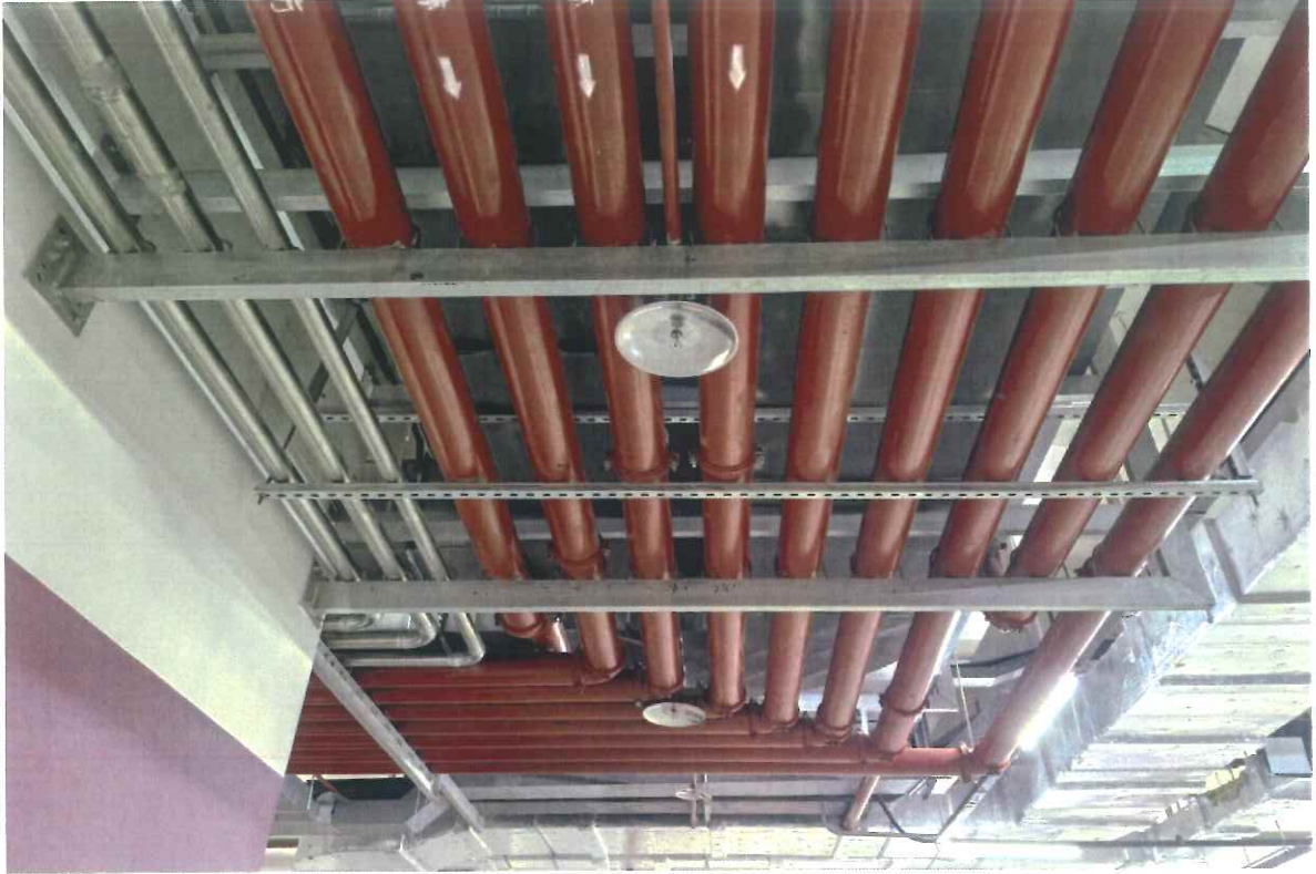
启东农商行大厦地下室管道
