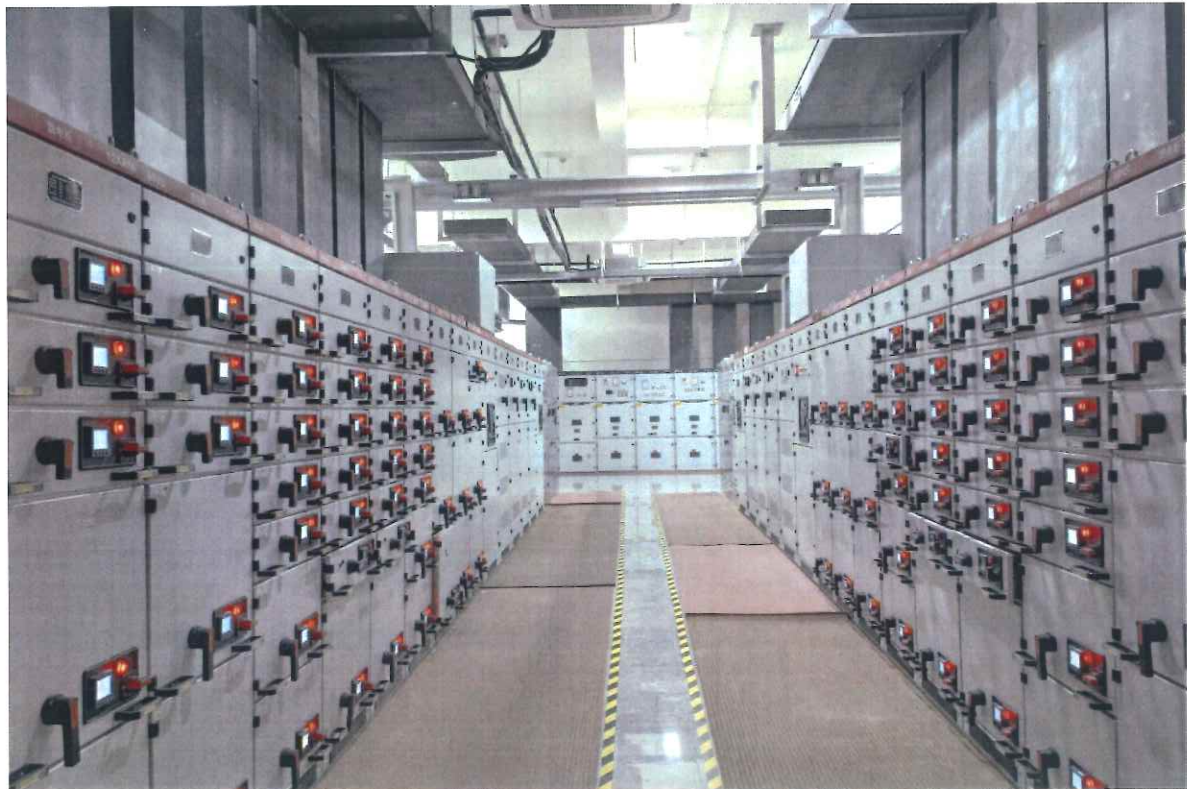
启东农商行大厦地下室配电室
