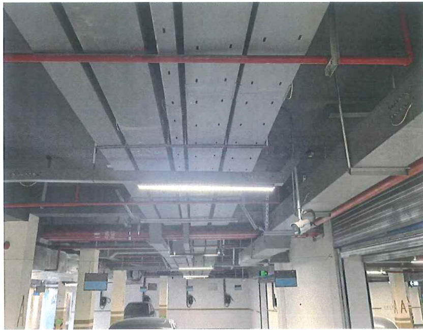
地下车库管线
