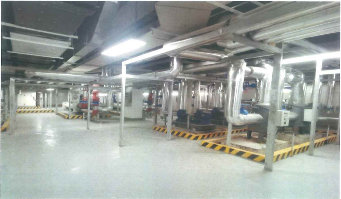
照片 7：城港路站环控机房
